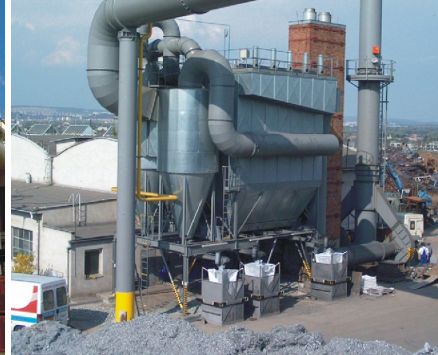
odprašení tavicích pecí hliníku filtrační výkon 100 000 m 3 /h
